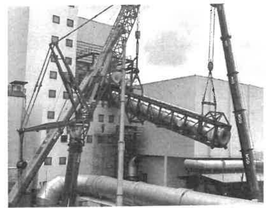
An drei Autokränen schwebt das Heißgasrohr und wird millimetergenau in die Mannheimer Phosphor-Recycling-Anlage von MVV eingehoben.
