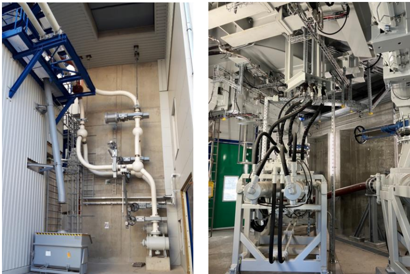
Aufnahmen 5 und 6: Nassschlammfördertechnik
