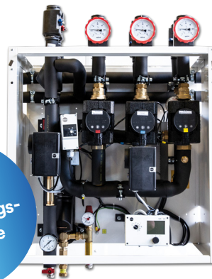
MVV Fernwärmestation T50
